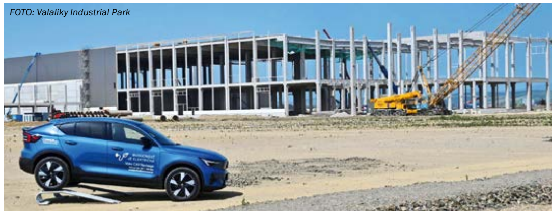
FOTO: Valalíky Industrial Park
